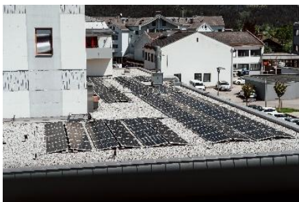
2023 PV- Anlage Feuerwehr Reutte 50 kWp, hiervon gehen 20kWp in die Feuerwehrrhalle und 30kWp in das Gebäude des Gemeindeamtes
